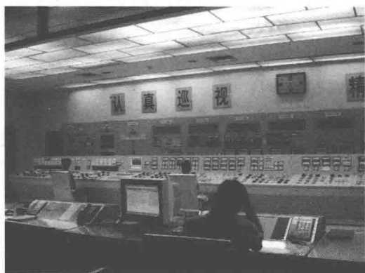
图 8-2 为某大型火力机组的机炉电集中控制室的场景照片,其中前排为值长台,中排和后排为机炉电控制与信号屏台。该照片中只照出了单台发电机的机炉电控制屏台。
